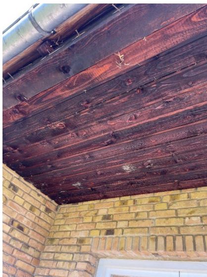
Fig. 7. Udhæng over haveterrasse med formentlig oprindelig halv transparent træbeskyttelse.
